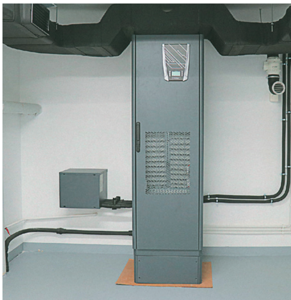
Fot. 5. Szafa klimatyzacji precyzyjnej Hi Ref.
