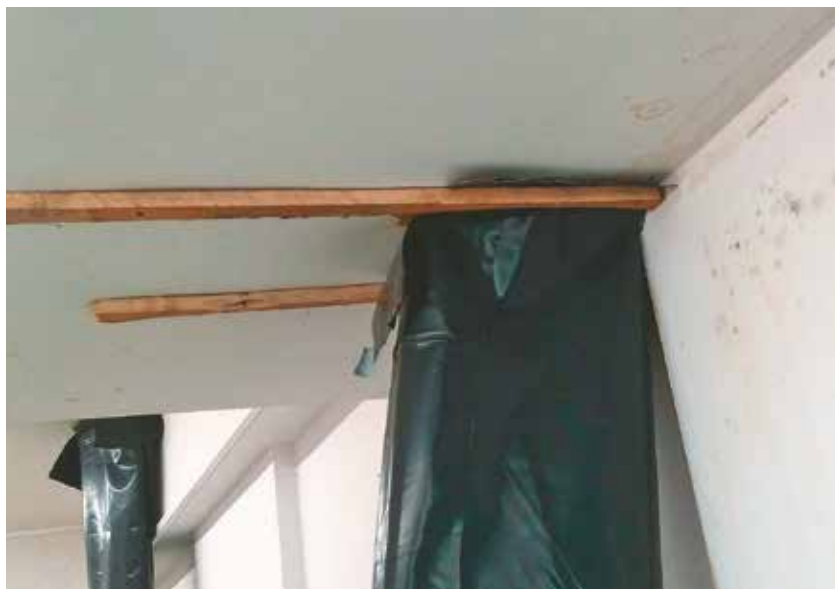
Fot. 3. Zabezpieczenie przecieku (fot. Maciej Wieczorek)
